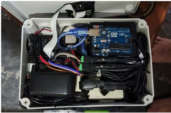
Gambar 11. Alat pada kotak panel
