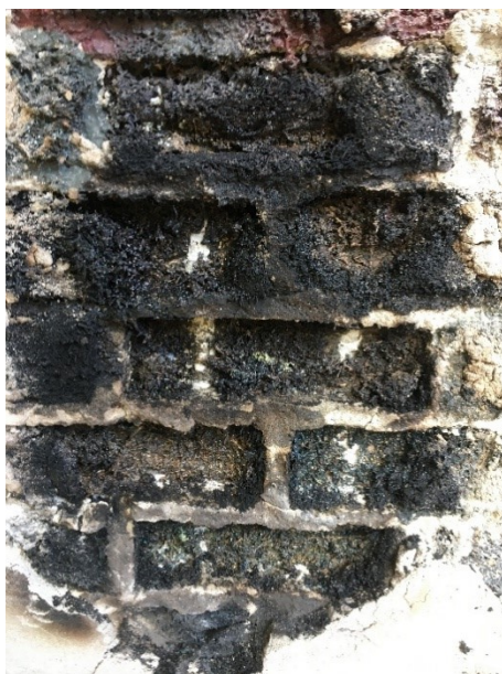
Gambar 7. Kondisi akhir sisi terekspose api
